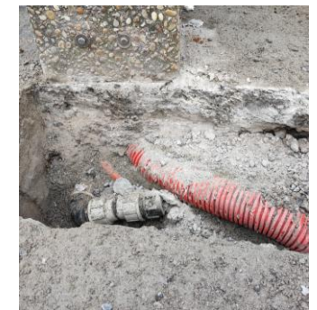
Réseaux non conformes aux règles de sécurité
